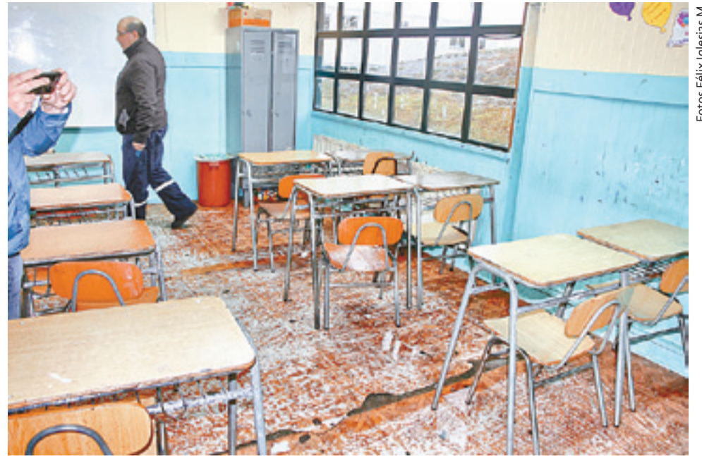
El hule de esta sala de 7° año básico no cubre el suelo: lo afea, y se debe al ingreso continuo de agua desde el exterior, una falencia que se replica en otras aulas de la escuela porvenireña.
